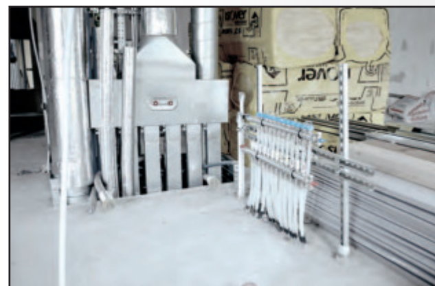
Heizkreisverteiler und Luftverteiler
