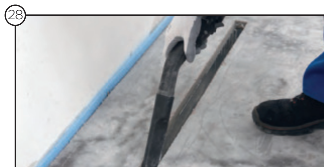
28 Reinigen des Ausblaskastens
