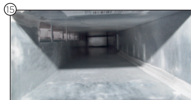
Kanalstrecke vor der Reinigung
