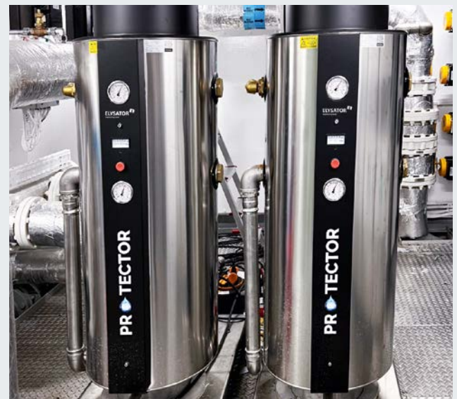
Geschlossene, fachgerecht installierte und sachgerecht betriebene Heizsysteme arbeiten durch Befüllung mit entsalztem Wasser und den Einsatz von Korrosionsschutzgeräten mit Schutzanodentechnologie, wie beispielsweise dem PROTECTOR by ELYSATOR dauerhaft und zuverlässig - ganz im Sinne der VDI 2035 Blatt 1.
